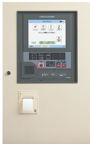
自動火災報知設備（火災受信機）
