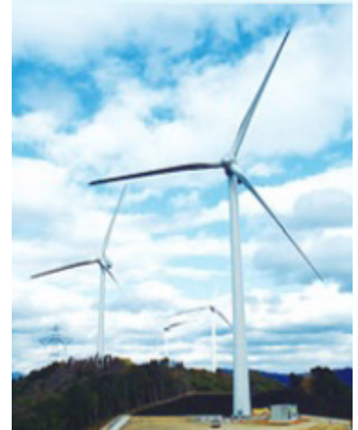
陸上風力発電設備
