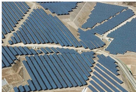
角田市太陽光発電所（WWB 開発）
