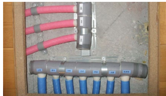
ヘッダー配管
